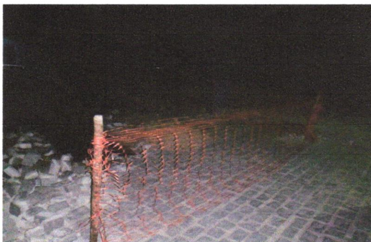
FOTO 01 - Tapume de proteção em tela de polietileno h=1,20 com bloco de concreto
